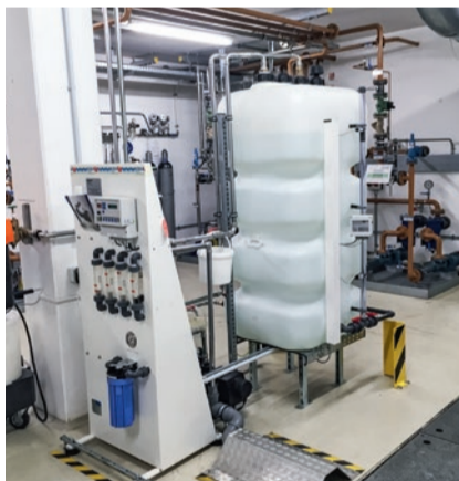
Sorgt für reines Wasser: die Osmose-Anlage.
