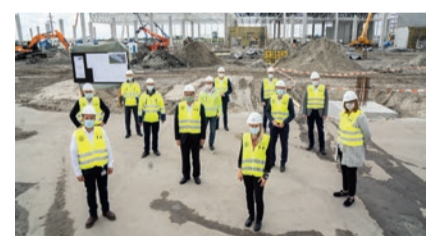
Gemeinsamer Besuch: Christian Vollmer besichtigte mit dem Werkmanagement und dem Betriebsrat die Baustelle.
