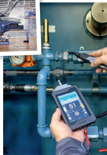
Prüfgerät im Einsatz: Das sogenannte Sonaphone hilft dabei, Druckluftlecks zu finden.
