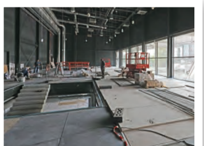
Großzügig: Bereits in der Bauphase ließen sich die Möglichkeiten des Foyers für Veranstaltungen erahnen.
