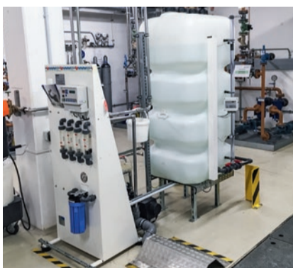
Sorgt für reines Wasser: die Osmose-Anlage.
