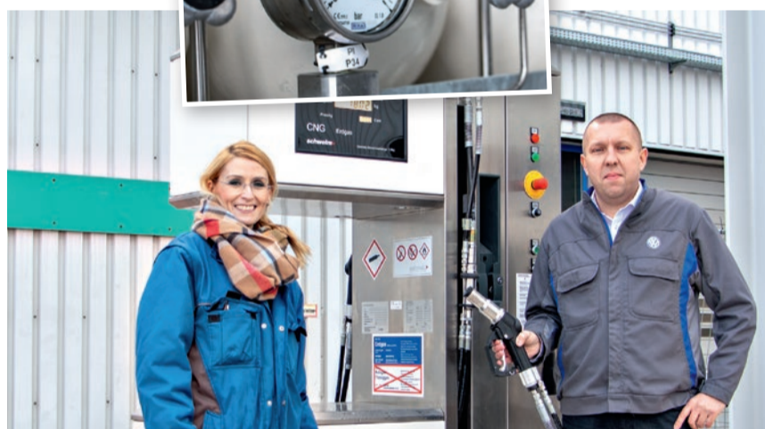
An der neuen Tankstelle: Daniela Paul, Planerin Versorgungstechnik, und Dariusz Gillner, Planer Befülltechnik und Projektleiter.
