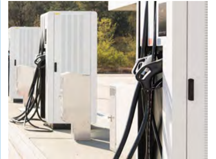
Auf dem Prüfgelände Ehra-Lessien: Neuer E-Ladepark verdreifacht die Ladekapazität.
