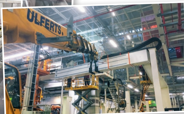
Karosseriebau, Aufbau: Auflegen des neuen, knapp fünf Tonnen schweren und verlängerten Kastenträgers.
