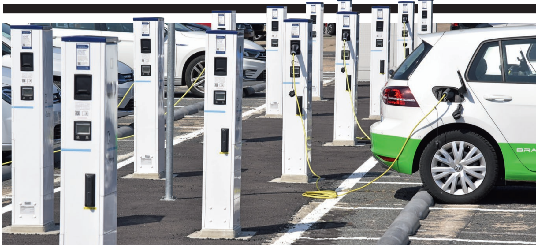
Insgesamt 30 Ladesäulen mit 60 Ladepunkten stehen auf dem Parkplatz Ohefeld bereit.
