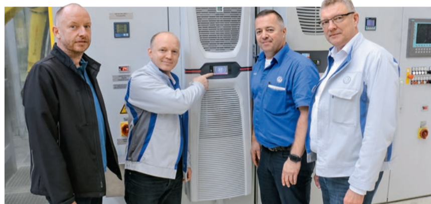
Eines der neuen Schaltschrankkühlgeräte in Halle 1 – bis zu 72 Prozent Energieeinsparung.
